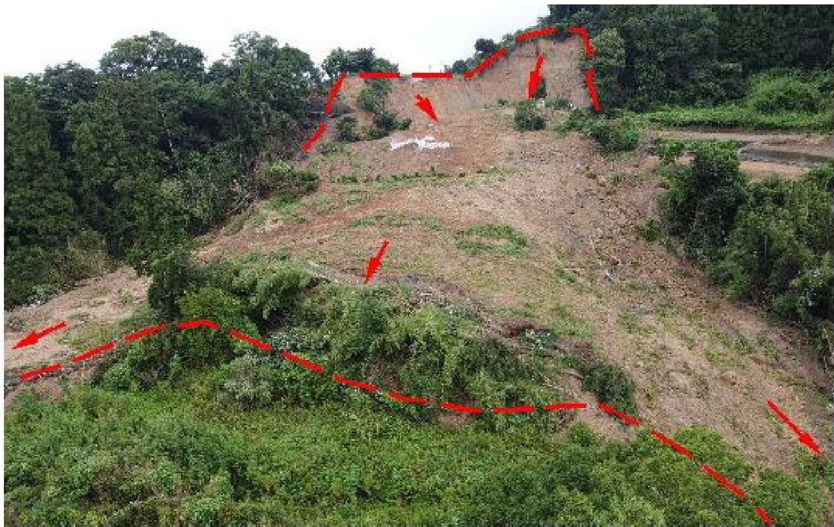
写真-2.1 被災箇所全景（長崎県資料より）
